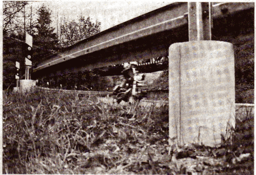
Schutzplankenprotektoren an den Trägerpfosten sollen die schlimmsten Unfallfolgen verhindern. Foto: Leonhard
